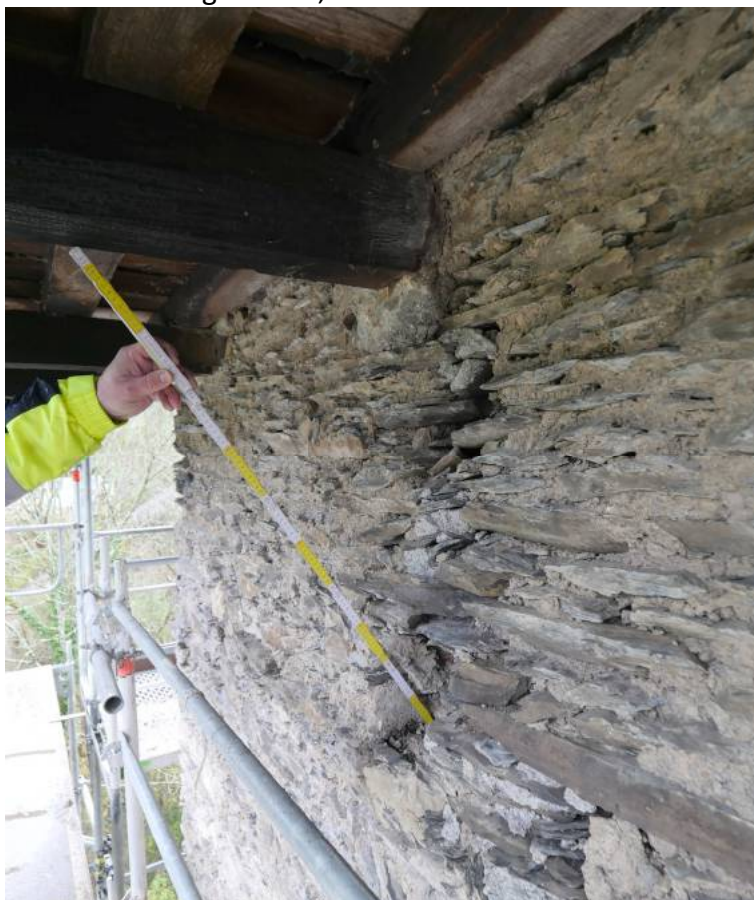
Abb. 6: 2. OG, fehlende Streben der Deckenbalken des Laufgangs im 3. OG
